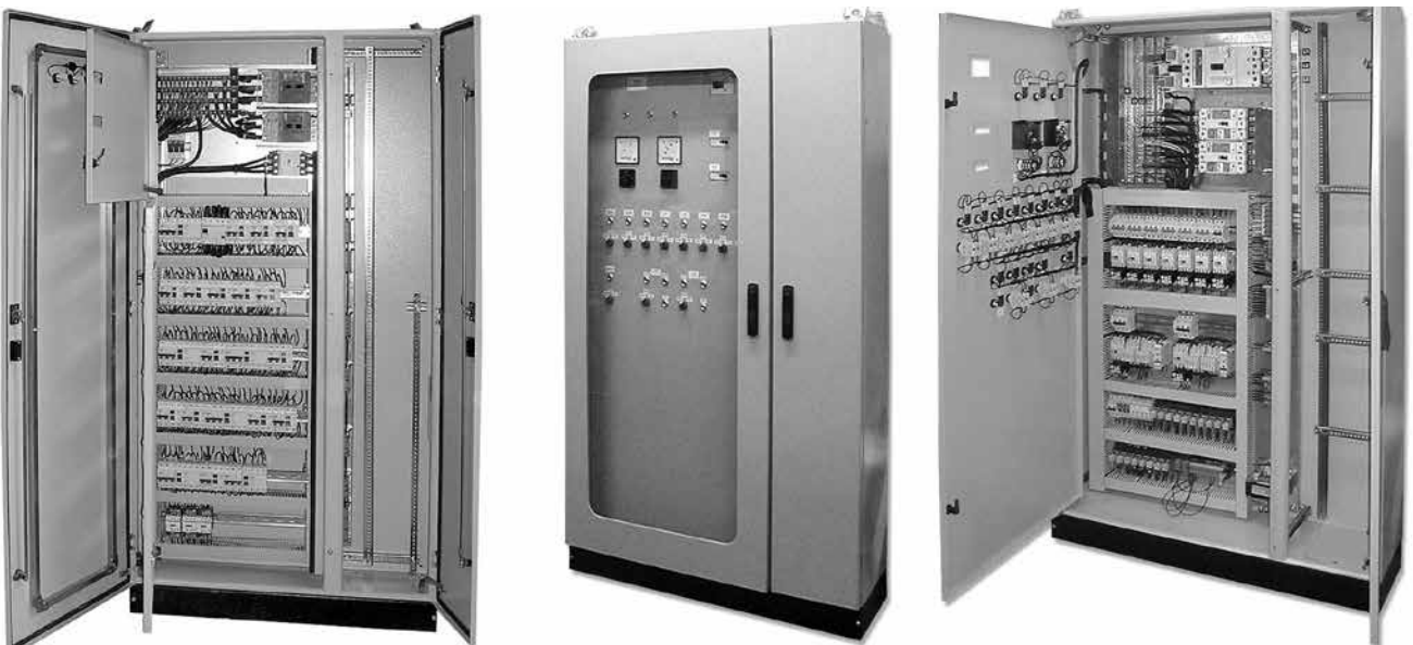
Integrador: Total Austral Obra: Mastering
