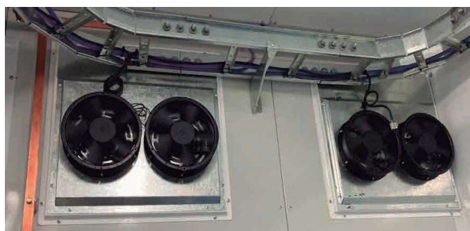
SHELTER CON FORZADORES EXTRACTORES EN SALA DE BATERIAS
